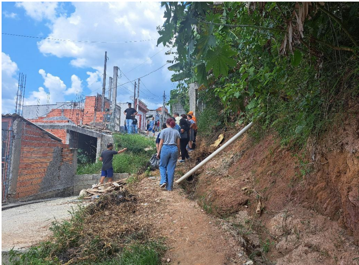
Figura 13 - Vista parcial a partir da Viela Jaguará, na visita in loco , com detalhamento quanto às tubulações e talude com taiobas. Fonte: A Autora (2024).
